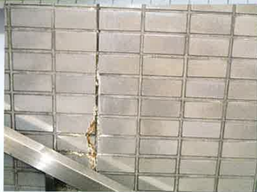
エフロは美観性を損なうだけではなく、タイルの剥落の原因となります。
