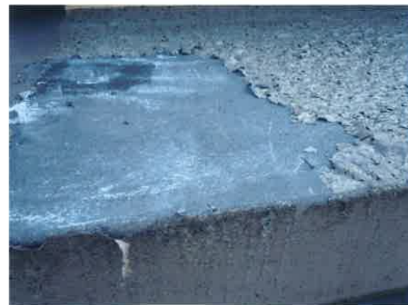
写真22 旧塗膜が取れた部分の状態。
