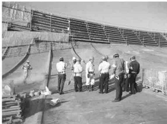
写真11 工事終了まで、何度も現場での密接な打合せと作業確認が行われた。
